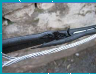
Câbles téléphoniques sectionnés par un écureuil à ventre rouge (© Bastelica F., ecureuils.mnhn.fr , 2016)
