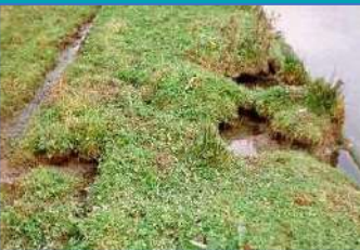
Dégâts réalisés sur une berge par un rat musqué : de nombreuses galeries font s'effondrer la berge, créant un danger pour les accès avoisinants (© serel-nature.com, 2016)
