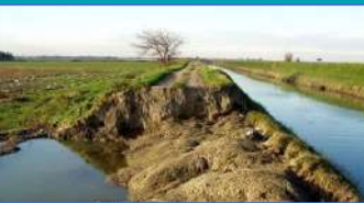
Dégâts réalisés sur une digue par un (ou plusieurs) ragondin(s), menaçant de facto la sécurité publique en risquant de provoquer des crues (© arles-info.fr, 2016)
